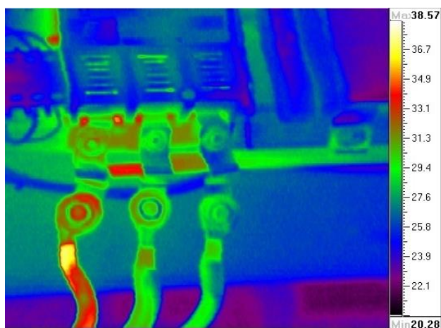
Рисунок 21. Пример термограммы контактных соединений с температурной шкалой
